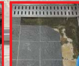
바닥파손 및 건물노후화
